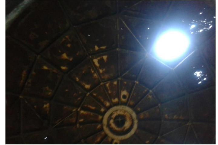
Slika 5. Rekonstrukcija rezervoara – oštećeni krov rezervoara od korozije
