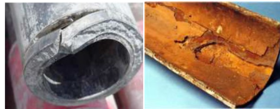
Slika 1. Kisela islatka korozija [1, 2]
